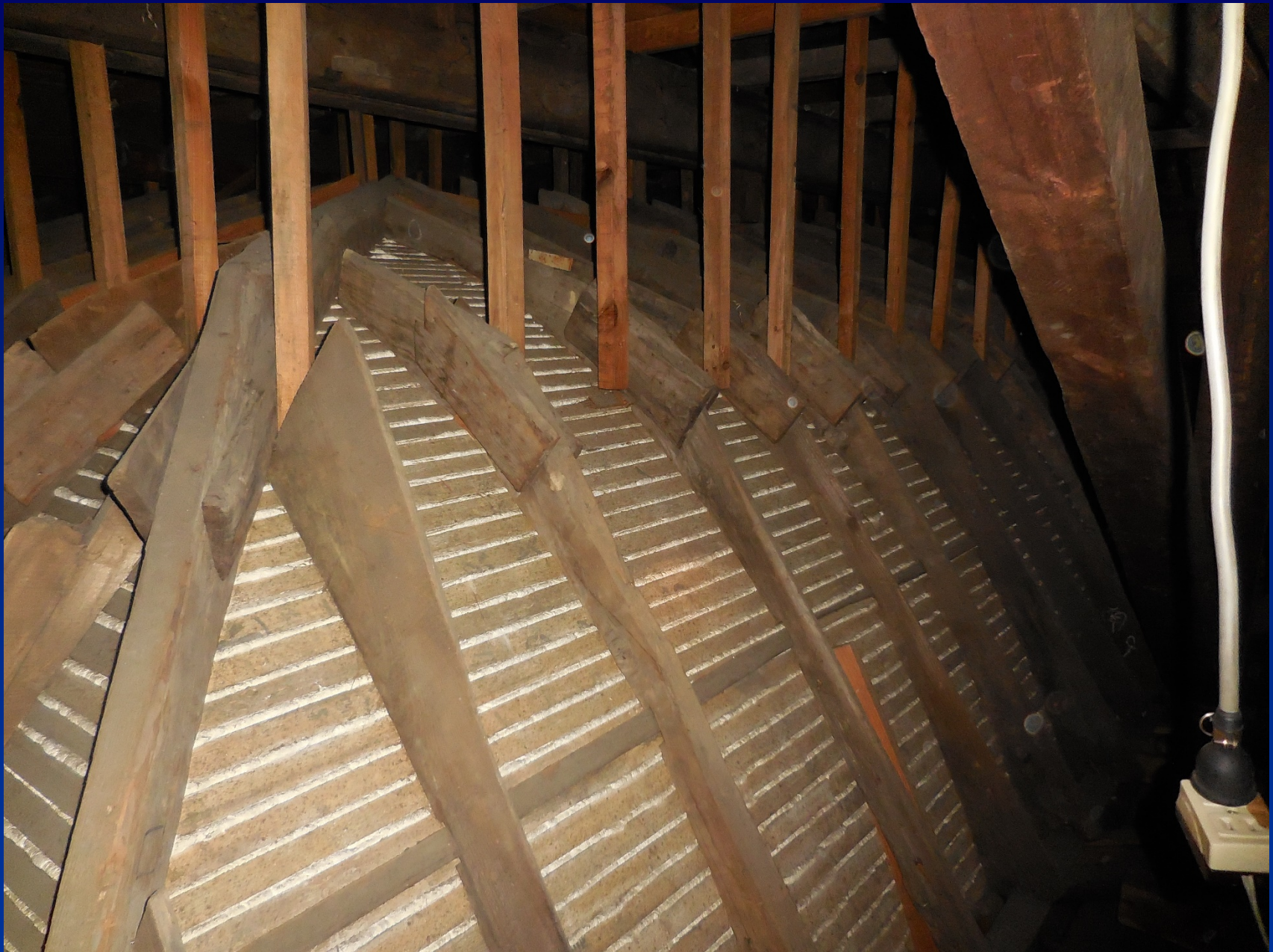
140516 奏楽堂修理前天井
