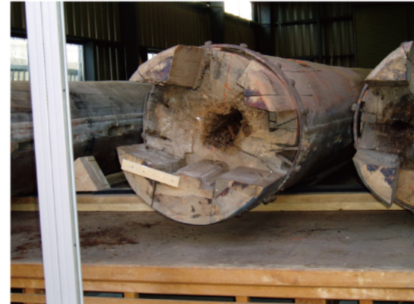
柱頭仕口の折損・釘孔腐食
