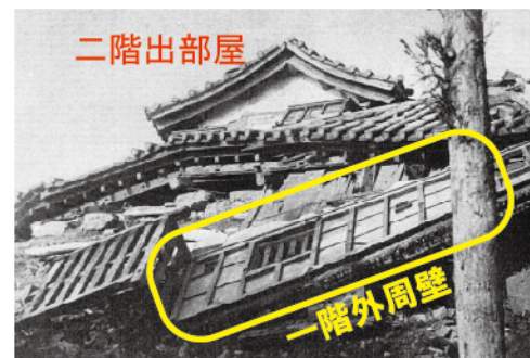
(b) 一階外周壁と二階出部屋の形状・南面 建物部分の被害写真：福井地震 ©坂井市
