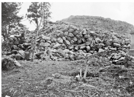
(a) 石垣の崩壊・北面東側
