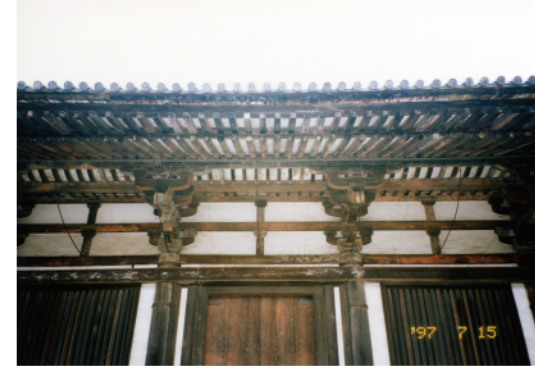
軒先の垂下変形
