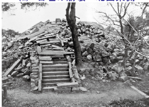
(b) 石垣の崩壊・東面階段
