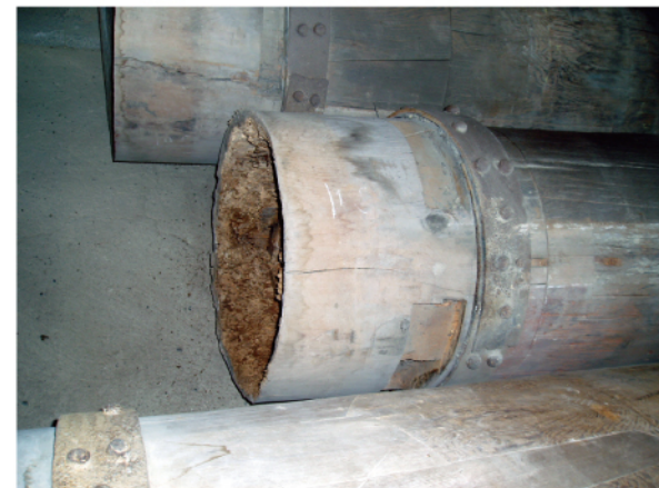
柱脚底面の蒸れ腐り
