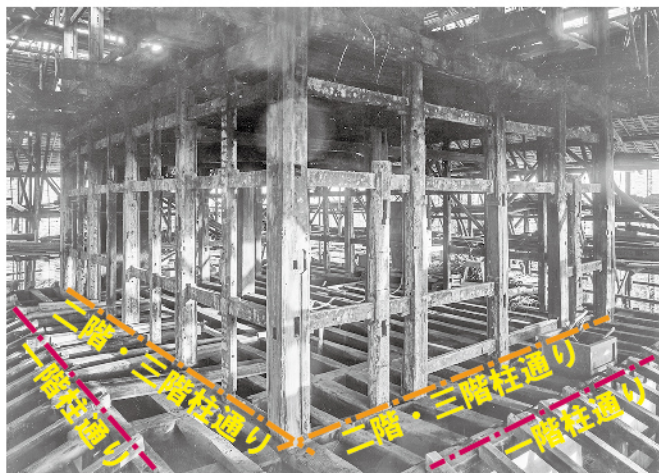
一階柱通りと二階・三階柱通りのずれS17年 @坂井市
