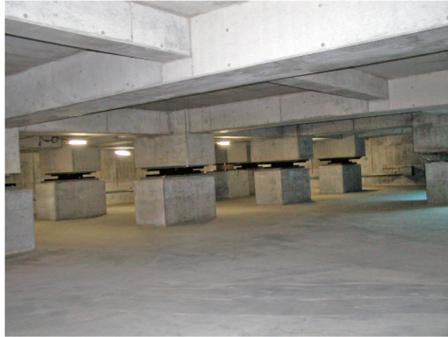
免震装置全景・南西方向
