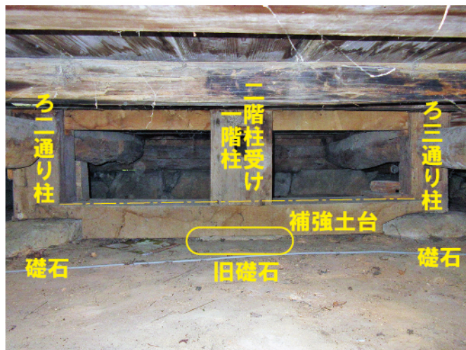
二階柱受け一階柱脚部の土台の沈下：北列西側 ©坂井市
