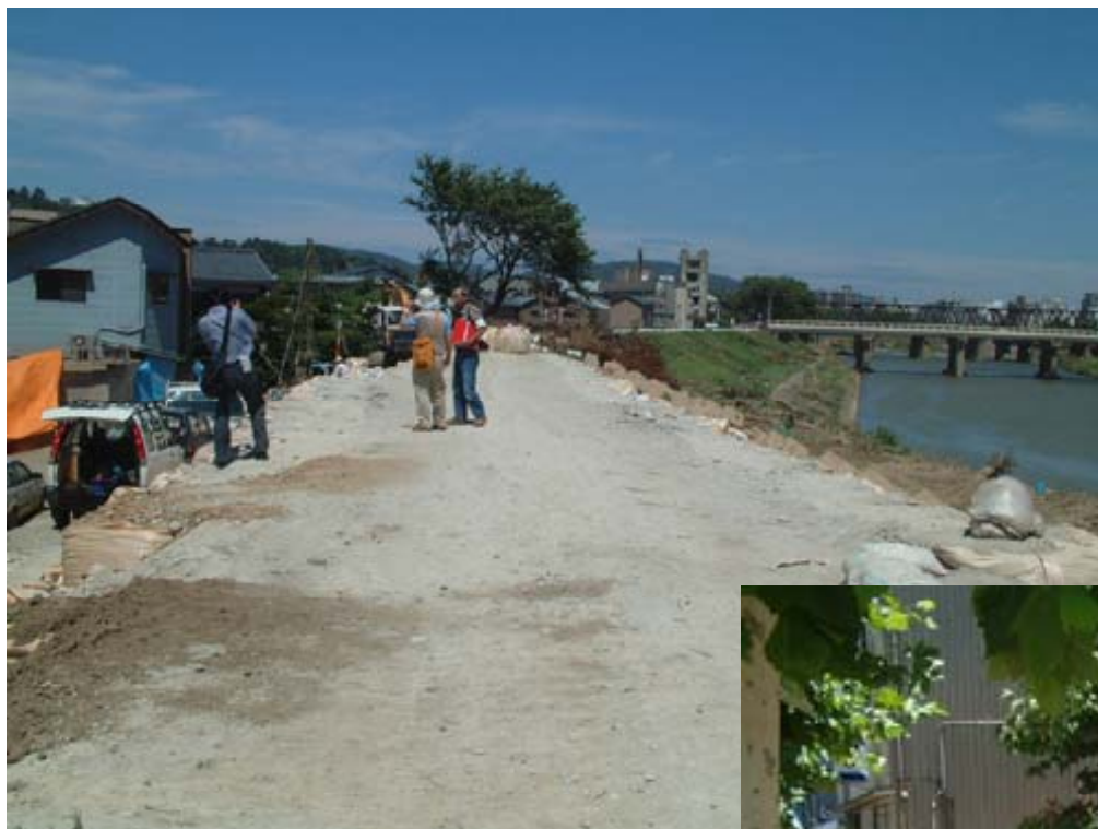
足羽川・春日破堤地点 堤防高:約3m (2004・8・2 撮影:大熊)
