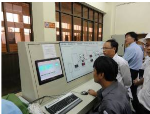
配水ポンプ場
